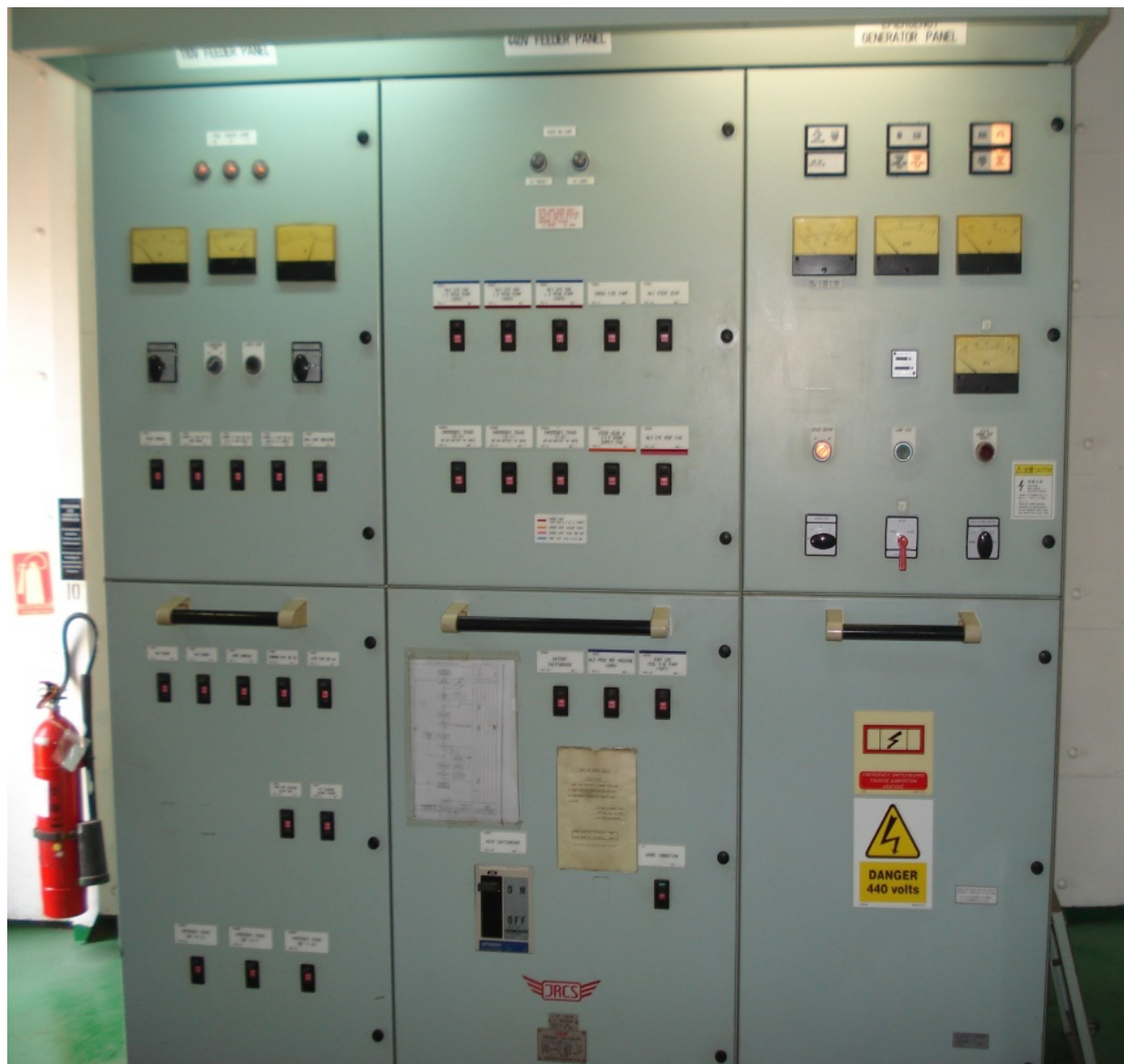
Рис. 3. Загальний вигляд аварійного розподільного щита (АРЩ)
