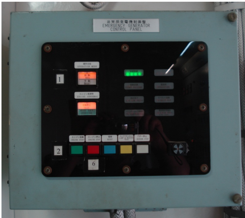
Рис. 6. Панель управління АДГ. (EMERGENCY GENERATOR CONTROL PANEL)
