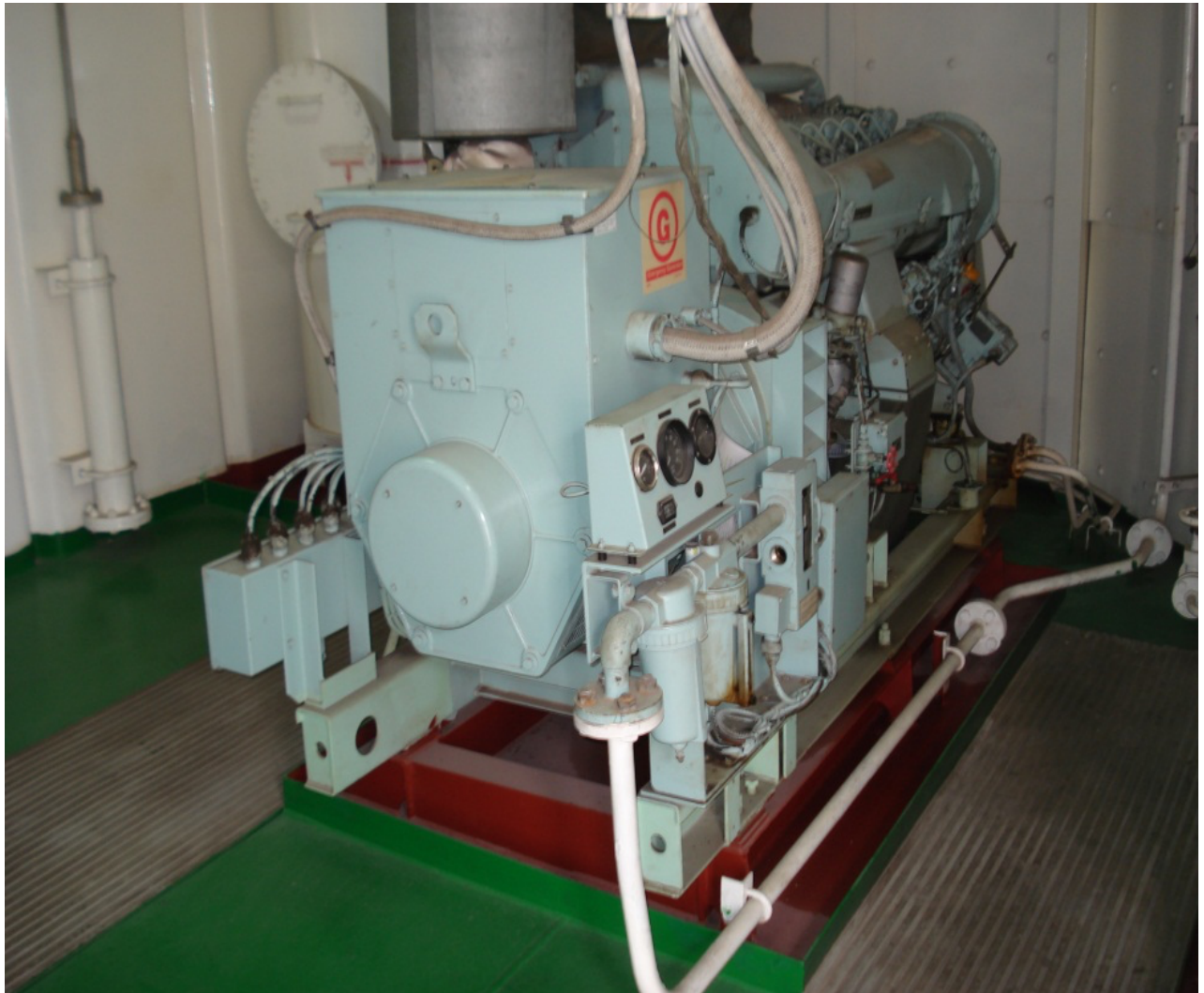
Рис. 2. Аварійний дизель-генератор (АДГ) (EMERGENCY DIESEL-GENERATOR/EDG)
